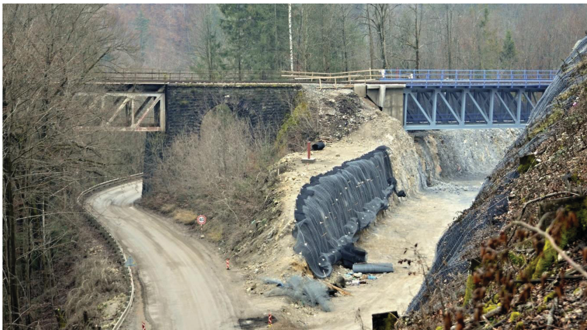
Obr. 2 Objekt 205-00 Most na železničnej trati č. 174 nad cestou I/72 v km 2,059 počas výstavby. Vľavo je pôvodný most, vpravo nové pole.
